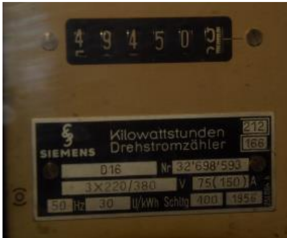
Siemens-meter uit de jaren 1960
