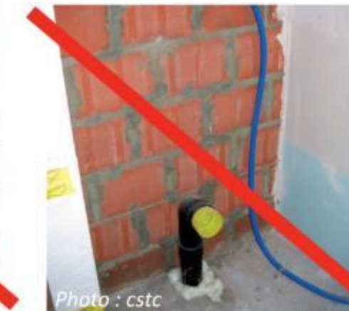
Niet-bepleisterde muur achter de wc: INFILTRATIES
