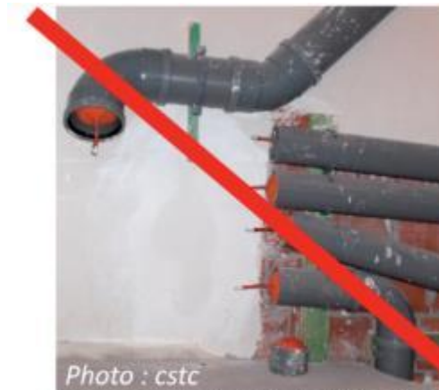
Niet-bepleisterde muur achter de leidingen: INFILTRATIES
