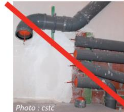
Niet-bepleisterde muur achter de leidingen: INFILTRATIES
