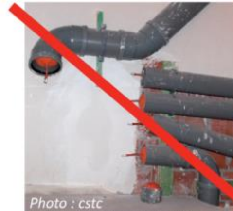
Photo : cstc Niet-bepleisterde muur achter de leidingen: INFILTRATIES
