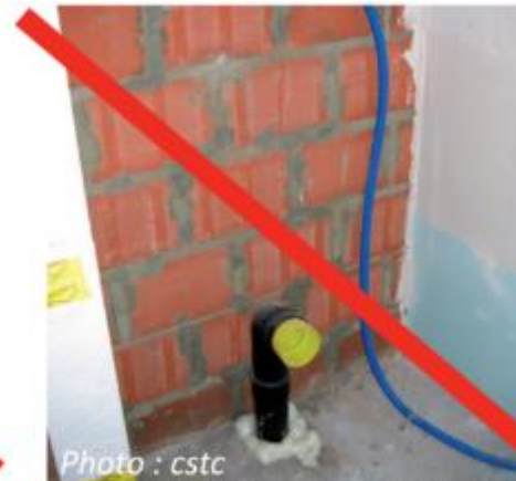
Photo : cstc Niet-bepleisterde muur achter de wc: INFILTRATIES
