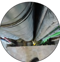
Centrale technische koker
