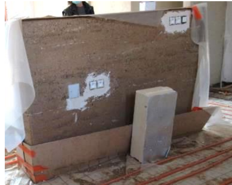
Elektrische inbouwdozen met gips in de kleimuur bevestigd
