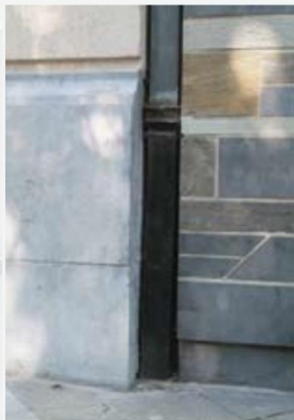
Descente d'eau de pluie intégrée dans l'épaisseur de la façade.
