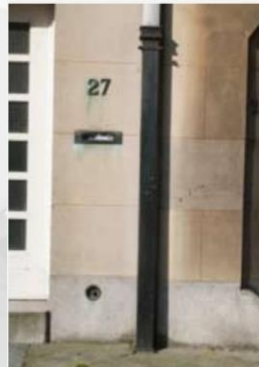
Descente d'eau de pluie apparente munie d'une souche pluviale de 1 mètre de haut minimum.
