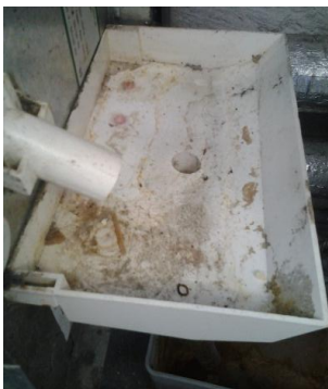
Figuur 5.3 condensaatopvangbak van een ventilo-convector voor het reinigen____
