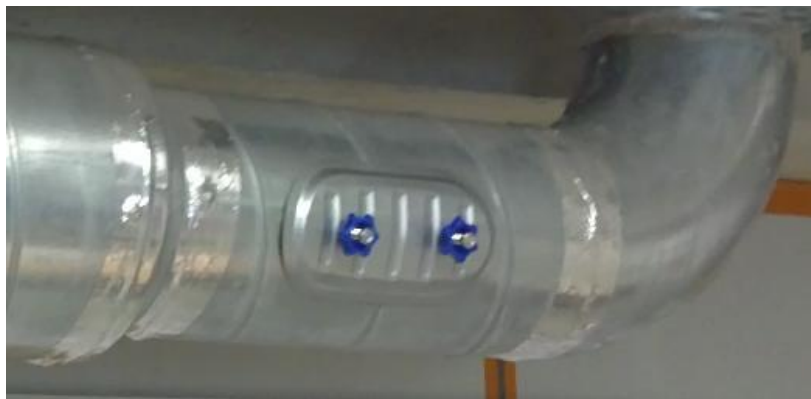
Figuur 3.1 : luchtkanaal met inspectieluik
