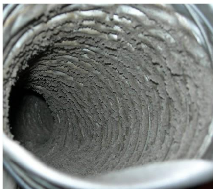
Figuur 3.2 : binnenwanden van een luchtkanaal vuil
