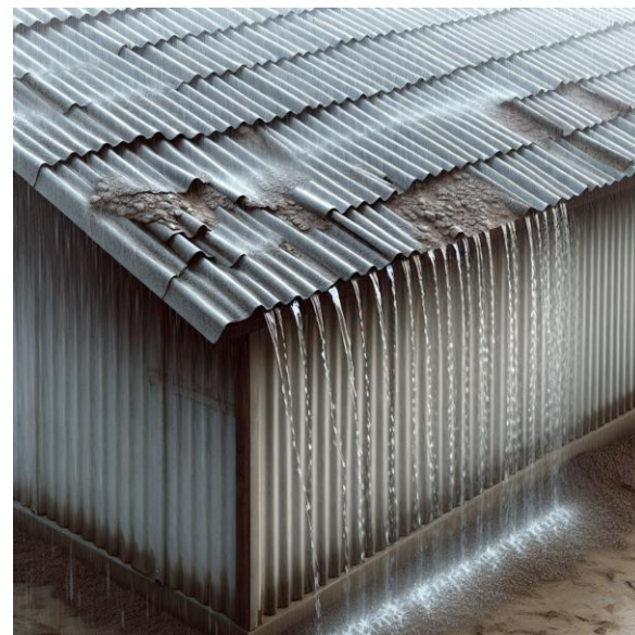
Afdruipzone dak met asbest (AI generated)
