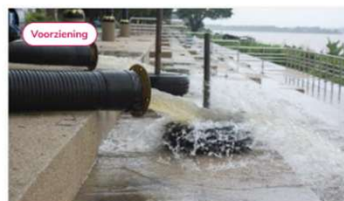
Voorzieningen voor de technieken in geval van overstroming
