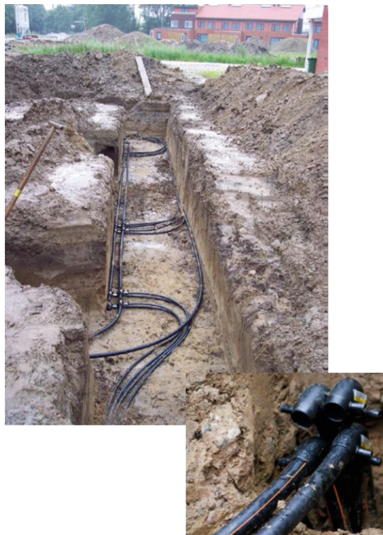
Réseau hydraulique horizontal
