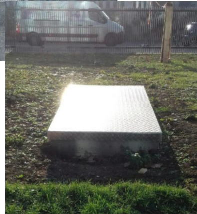
Puits de production / Tampon carrossable ou surélevé
