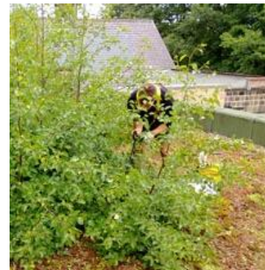
Jonge bomen op het dak door gebrek aan onderhoud Bron: turfonline.co.uk
