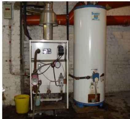
Figure 1.2: exemple de vieille installation
