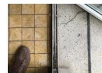
Granitos des balcons Loc: Balcons avant et arrière Formats: granito coulés Aspect: blanc moucheté + liserets noirs Composition: granulats de quartz liés au ciment Etat: Mauvais à moyen Fixations: coulé sur chape faiblement liée Projet: Zones 1 (balcons cuisines) : retirés et évacués Projet: Zones 2 (balcons chambres) : conservé + réparations ponctuelles
