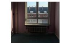
Finitions murales / papiers peints Loc: toutes pièces Formats: Aspect: papiers peints, divers Composition: encore inconnue Etat: mauvais à moyen Fixations: collé Projet: suppression du papier peint Projet: sur parois isolées: isolation Projet: autres parois: enduisage fin de réparation: peinture.
