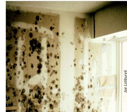
Exemple de moisissures dues à la condensation.
