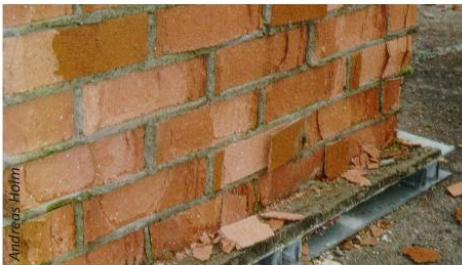
Exemple de briques gélives soumises au gel.
