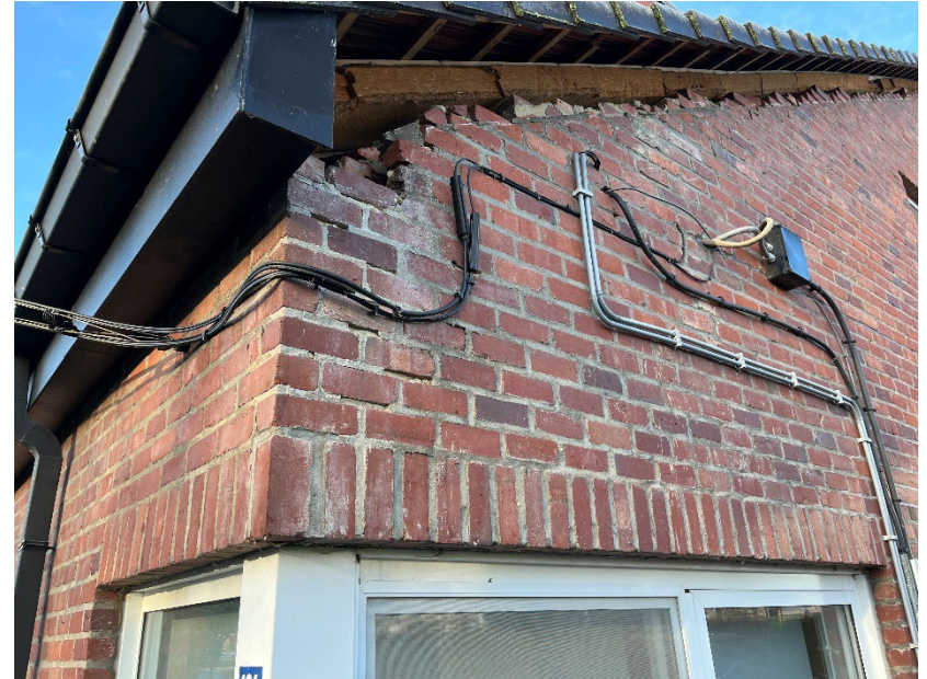
Vorstschade en open spouw op aansluiting met het dak
