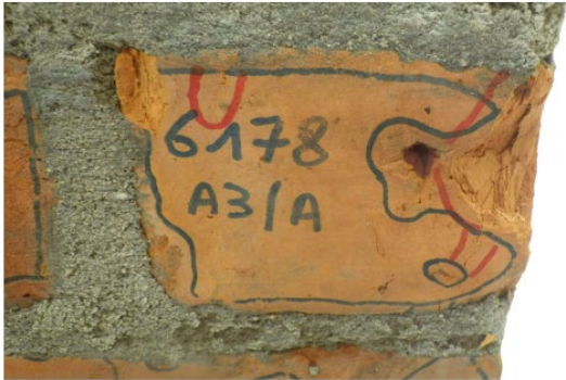
Verbrokkeling zijkant (lokaal)
