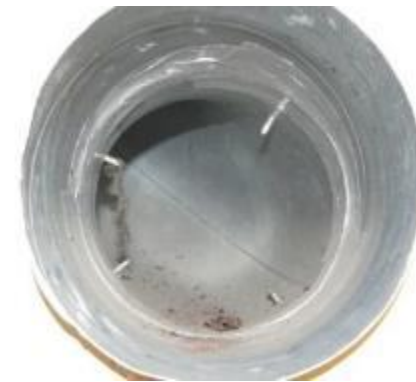
Verkeerde filter → Vuile pijpen!
