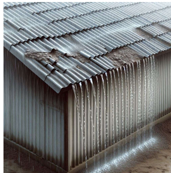
Uitdruipzone dak met asbest (AI generated)
