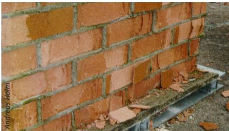
Exemple de briques gélives soumises au gel.
