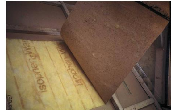
Exemple de moisissures à l'arrière de la membrane pour réguler la vapeur.
