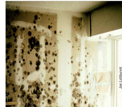
Exemple de moisissures dues à la condensation.
