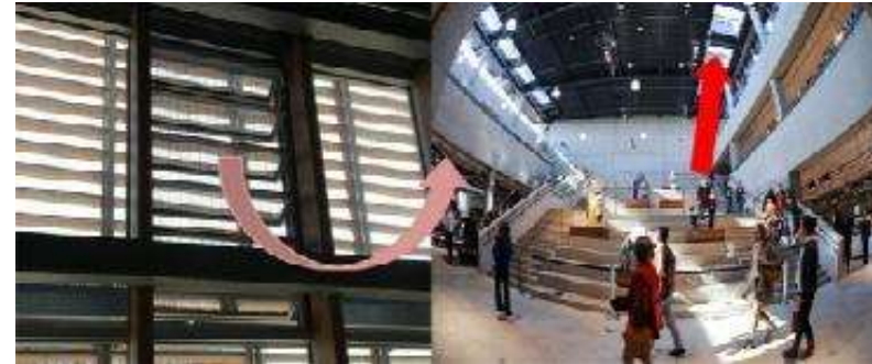
Openende roosters/kleppen voor de luchttoevoer (links) en luiken in de hoogte voor de luchtafvoer (rechts)
