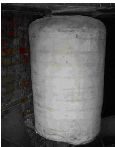
Met asbesthoudende pleister geïsoleerd expansievat
