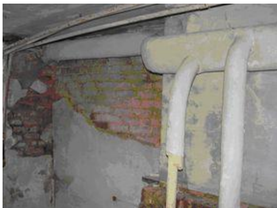
Oude éénlagige warmte-isolatie van asbestvezels bevattende diatomeeënaarde
