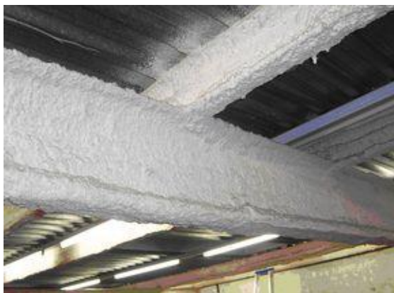
Harde asbestbepleistering op metalen steunbalken gespoten.
