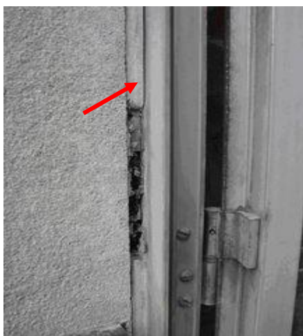
Asbesthoudende mastiek aan een vensterlijst
