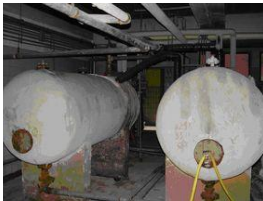
Warmwaterreservoirs bekleed met asbesthoudende pleister
