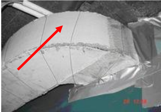
Asbestkarton (licht geplooid oppervlak) rond een ventilatiekoker
