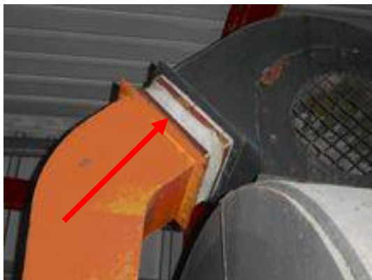
Trillingsdempende balg ter hoogte van de verbinding tussen ventilatiekoeler en motor
