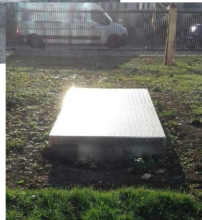
Puits de production / Tampon carrossable ou surélevé
