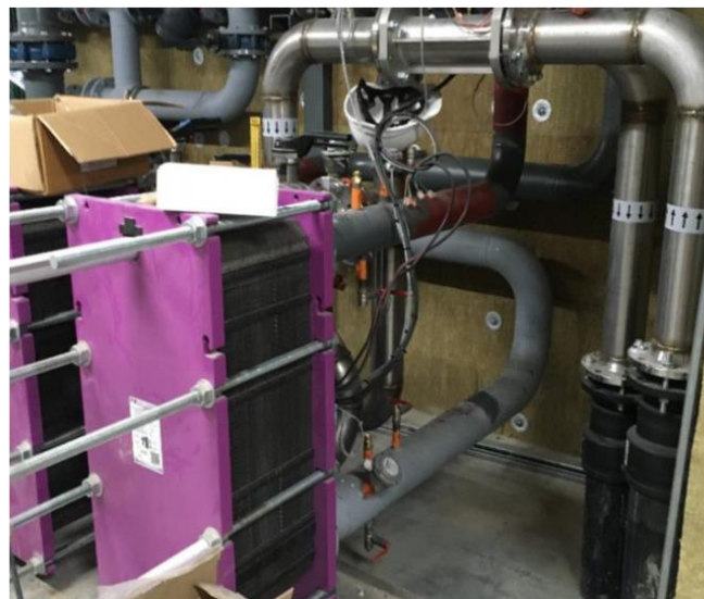
Echangeur à plaques géothermique
