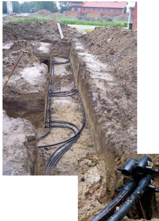
Réseau hydraulique horizontal
