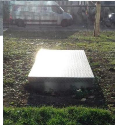
Puits de production / Tampon carrossable ou surélevé
