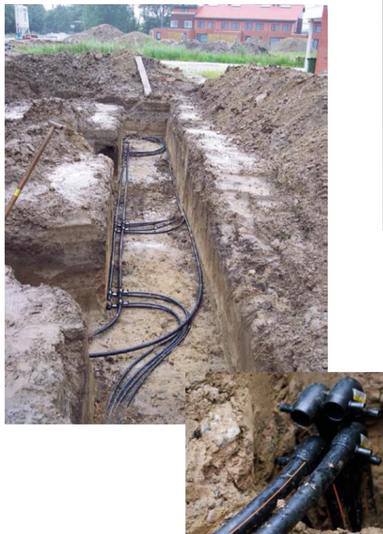
Réseau hydraulique horizontal
