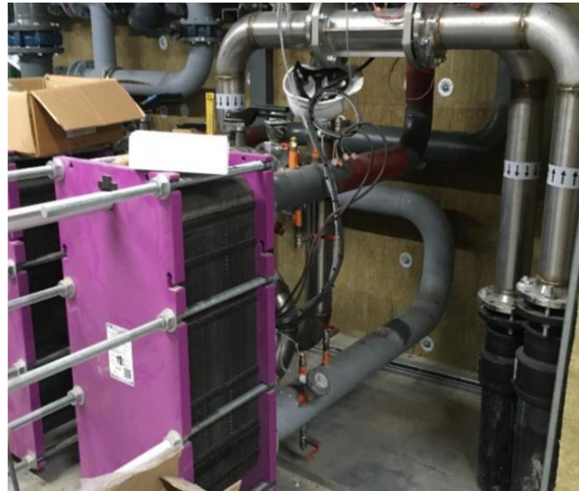
Echangeur à plaques géothermique
