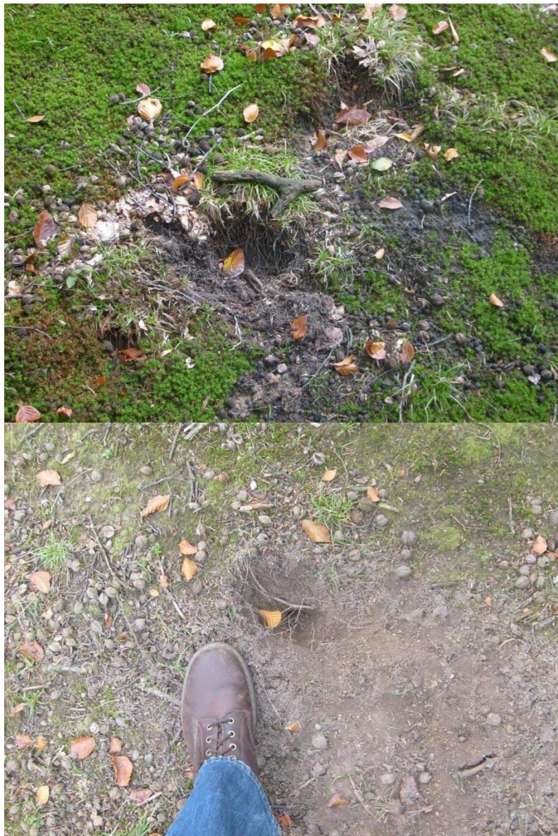
Foto 10 - Schade door scharrelende dieren
